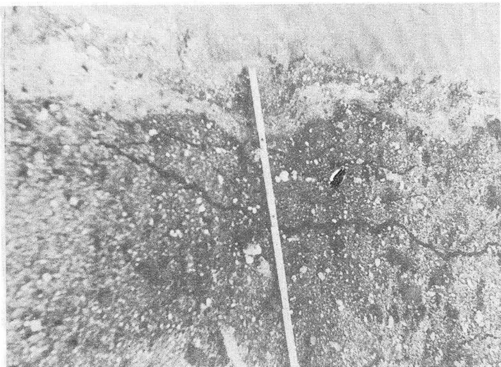
Bild 5 Setzungsrisse unmittelbar über der Wasserspiegellinie
