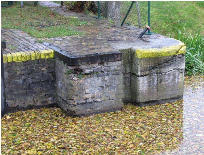
Bild 1: Oberhaupt-Notverschlussnische mit gerissenem Mauerwerk
