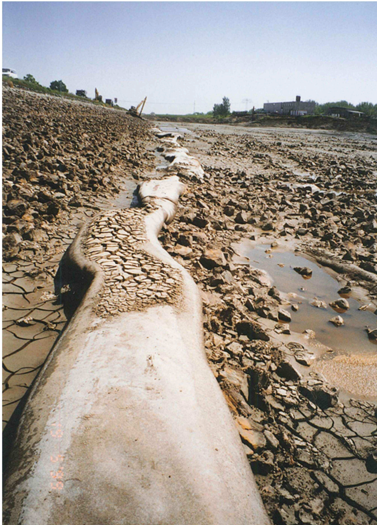
Bild 2: „Wurstbildung“ im Übergang Sohle/Böschung am MLK
