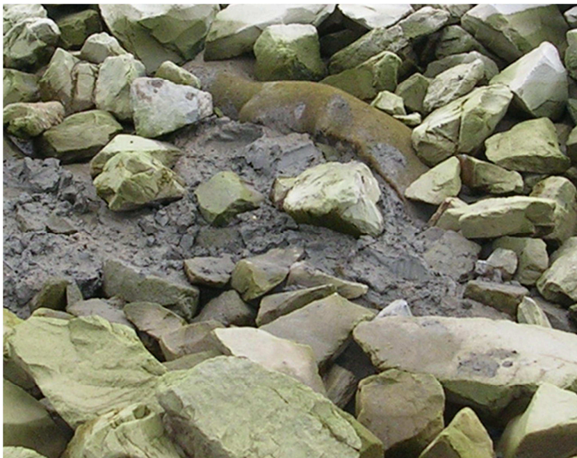
Bild 5: Faltenbildung und fehlende Deckschicht
