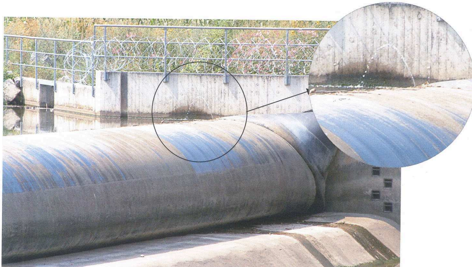
Abbildung 2: Lokaler Wasseraustritt aus einer Schlauchmembran
