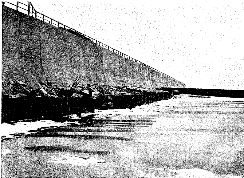
Abb. 11. Bei Sturmflut erfolgte Vertiefung des Strandes vor der Fußsicherung der Westerländer Strandmauer.
