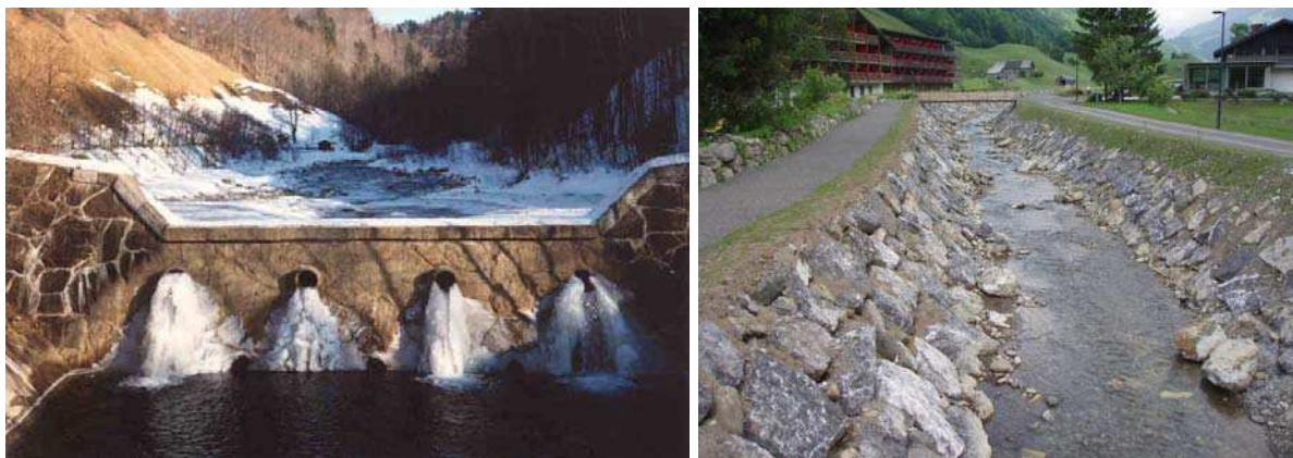
Abbildung 1: Geschiebestausperre bei hm 38,00 mit Retentionsraum und Regulierungsstrecke im Bereich der Ortschaft Reuthe bei hm 7,00
