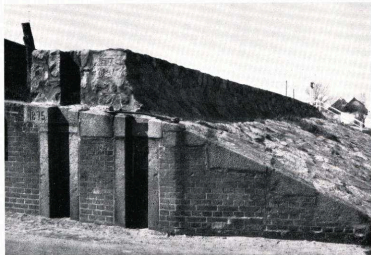
Abb. 38. DuEV Grube-Wessek, Kreis Oldenburg; Deichstöße im Steindeich vor Dahme, Baujahr 1875 Aufn. KANNENBERG, 1959
