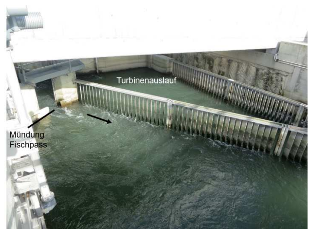
Bild 13: Zugabe des Dotierabfluss über eine verstellbare Lamellenwand, KRS, Hochrhein
