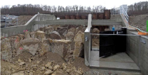
Bild 5: Mit Drehtor regelbares Einlaufbauwerk Verbindungsgewässer KW Ryburg-Schwörstadt
