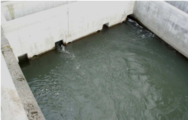
Bild 14: Sammelkanal FAA am KW Wettingen
