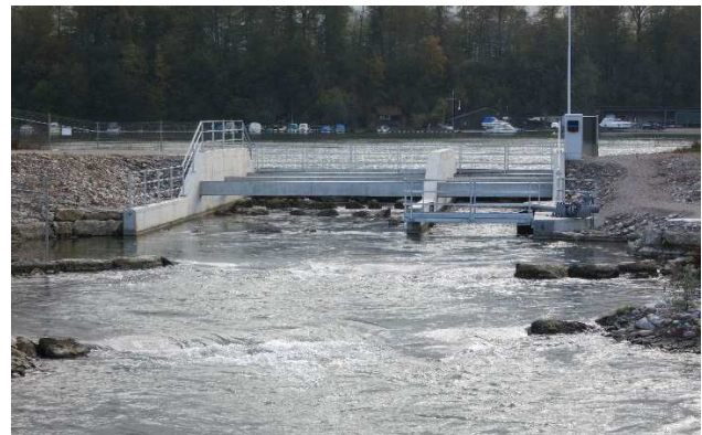
Bild 6: Voll geöffnetes Einlaufbauwerk
