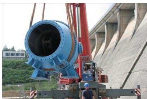
Abb. 7: Ausbau eines Ringkolbenventils DN 2000
