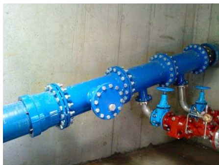
Abb. 6: Armatureschacht für mehrere Leitungsabhänge
