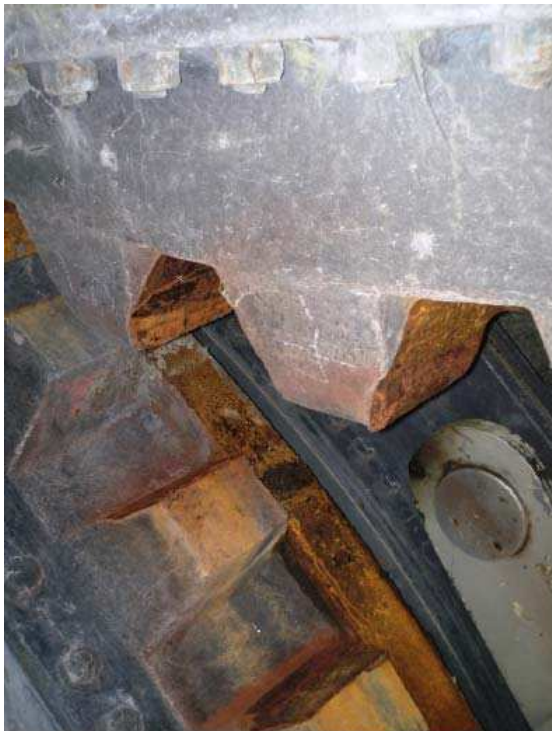
Bild 6: Abgenutzter Zahnkranz an einem Wehrverschlusses
