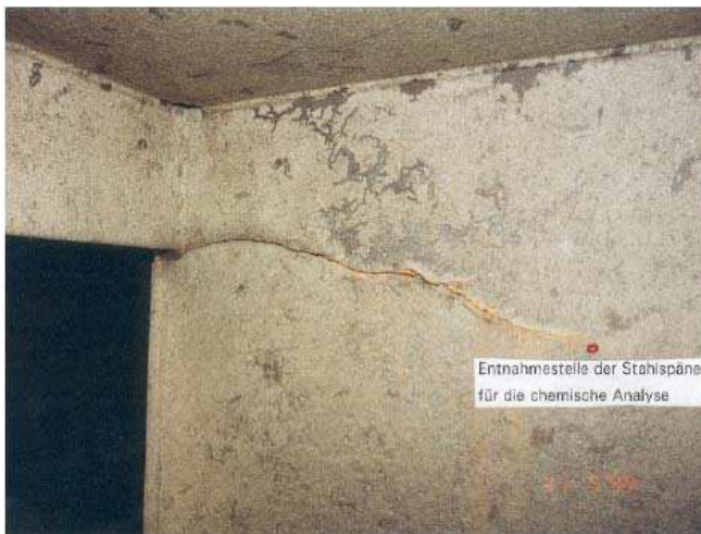
Bild 3: Risschaden am Endschott eines Schleusenverschlusses infolge mangelnder Ermüdungsfestigkeit
