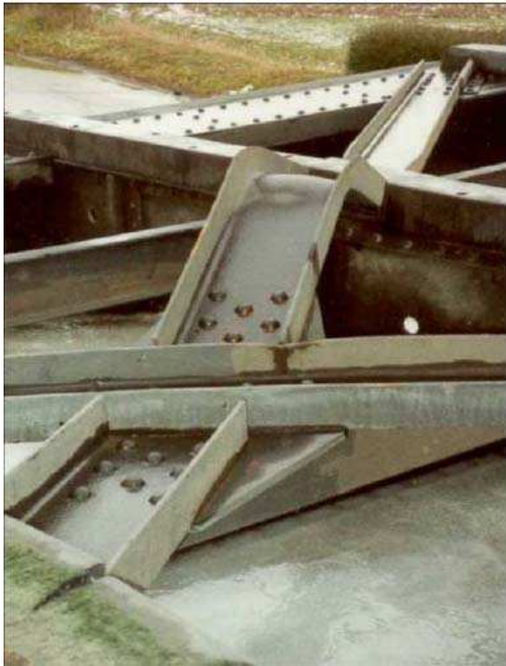
Bild 7: Schaden an einem Stemmtorflügel infolge Schiffsanfahrung
