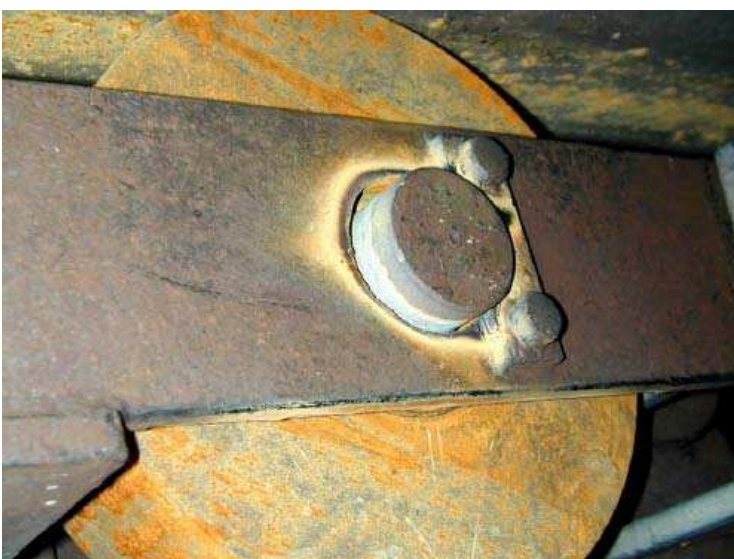
Bild 5: Achslagerungsschaden durch Bimetallkorrosion
