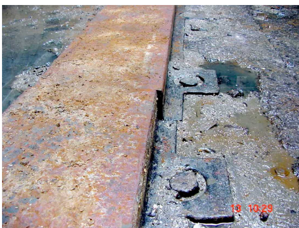
Bild 8: Schadenfeststellung; o.: Betonausbrüche und korrodierte Schienenverankerungen; u.: Versatz an vielen Schienenstößen
