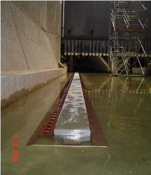
Bild 11: Eingebaute Unterwagenlaufschiene im Bereich der Torkammer; im Hintergrund der Drempeltunnel mit aufgehendem Torkammerverschluss und das Treppengerüst
