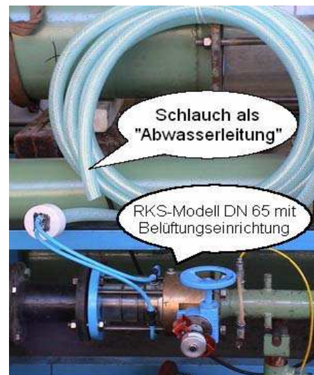
Abb. 7: Belüftung über lange Zulaufleitung
