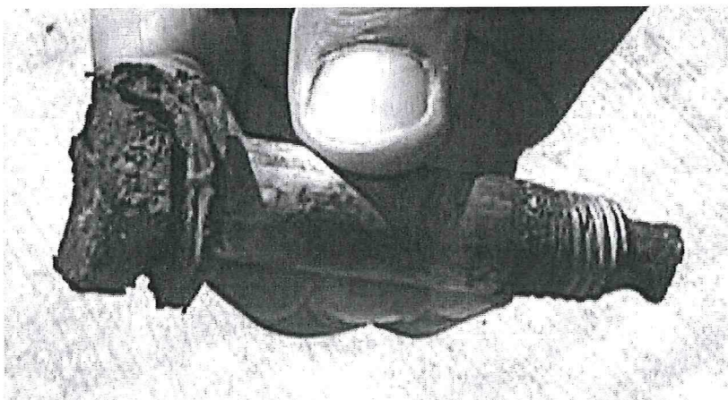
Bild 7: Abgerostete, verzinkte Schraube aus Baustahl
