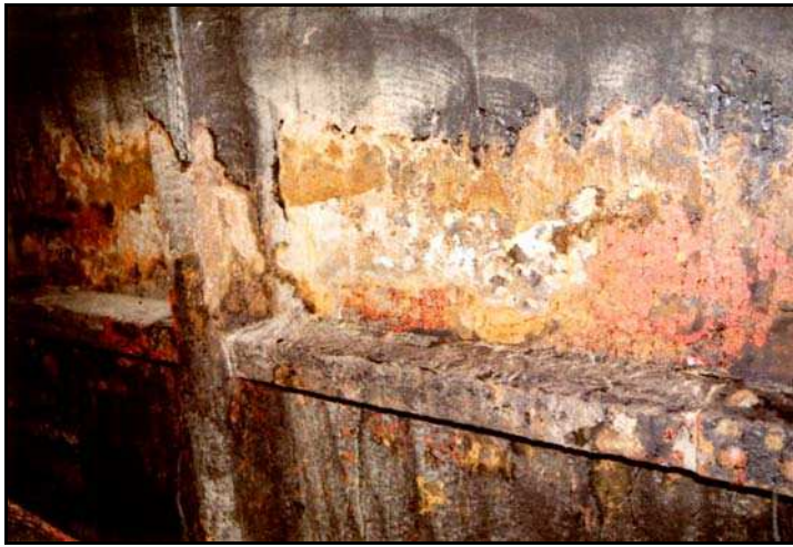
Bild 1a: Flächige Korrosion mit Durchrostung
