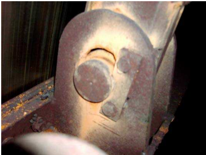
Bild 12: Schaden am Augenstab eines Umlaufverschlusses infolge Bimetallkorrosion
