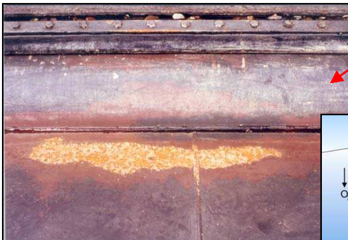
Bild 9a: Torsionsrohr und angeschweißtes Blech (unlegierter Stahl) einer Klappe
