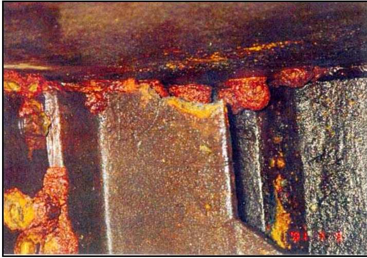
Bild 8: Rostpusteln am Baustahl der Wehrklappe, Ansicht vom Unterwasser
