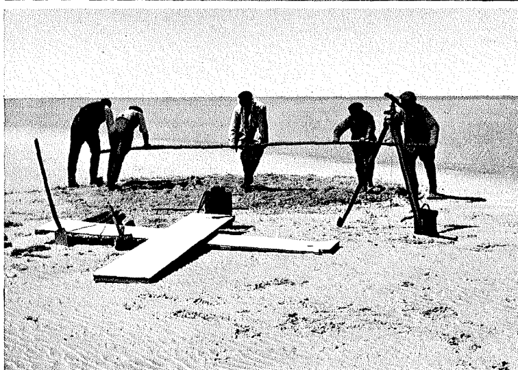
Abb. 5. Eindrehen eines Schraubeisens zur Sicherung eines Festpunktes im Watt. Vorne Holzkreuz für Fliegerpaßpunkt. Bildarchiv Westküste B — a 39 Aufn. E. G. Haberstroh
