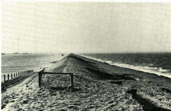
Abb. 9. Seedeich Ülvesbüll am Morgen nach der Sturmflut. Links der überflutete Koog, rechts das noch sturmbeugte Watten- meer an der Deichböschung Aufn. E. Wohlenberg
