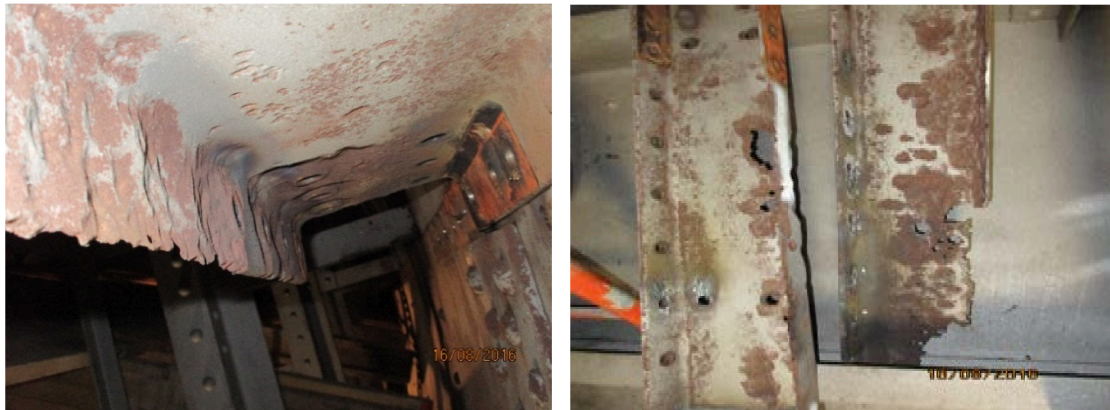
Abbildung 3: Typische Schadensbilder an Wehrverschlüssen
