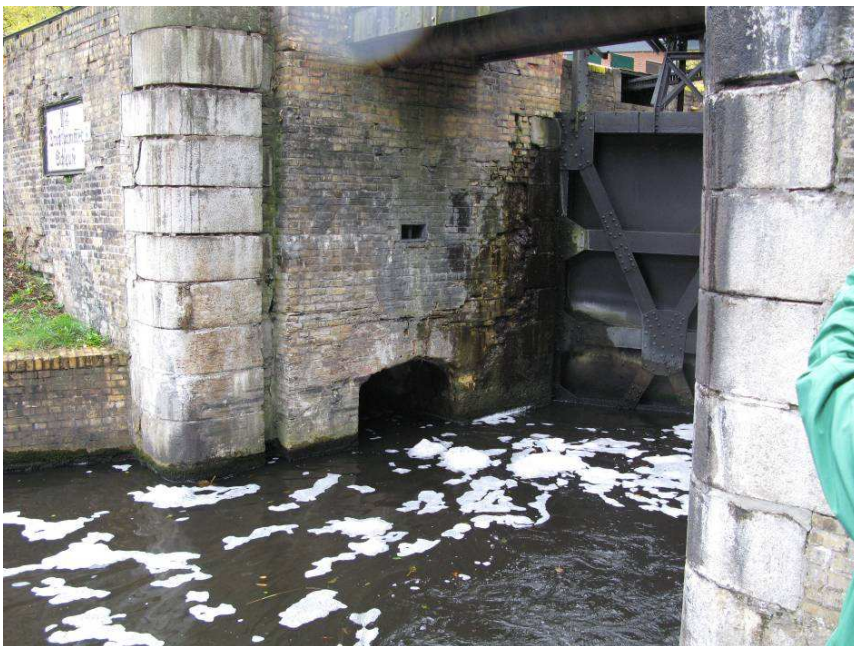
Bild 2: Unterhaupt mit wasserdurchlässigen Fugen, Materialverlust durch Abwitterung und schadhafter Kantensteinenkonstruktion
