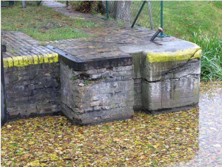
Bild 1: Oberhaupt-Notverschlussnische mit gerissenem Mauerwerk
