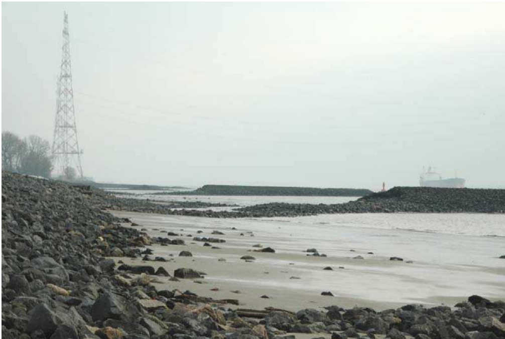
Bild 2: Zerstörte Buhnenwurzeln an der Unterelbe bei Juelssand (Foto: BAW, 2009)
