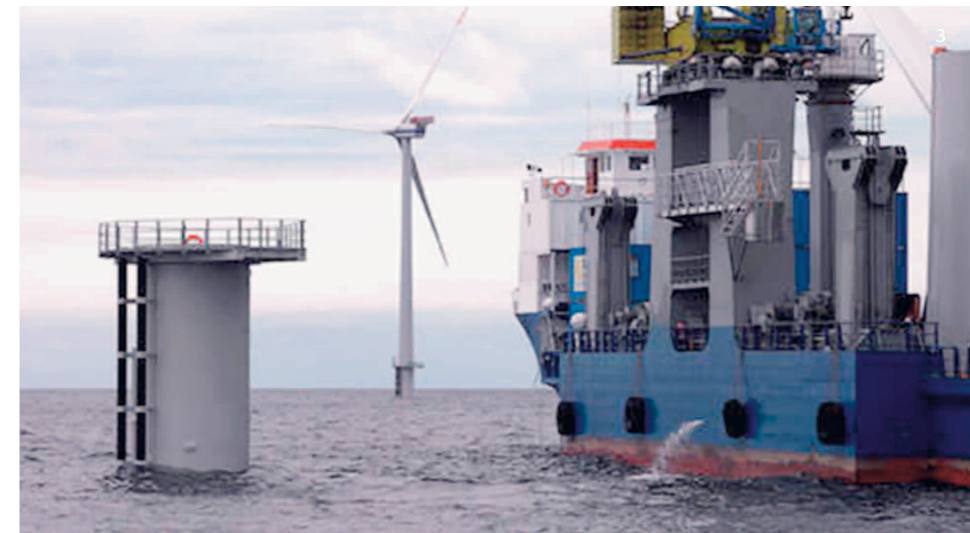
Abb. 1: Plattform für eine Offshore-Anlage © Vestas Central Europe
