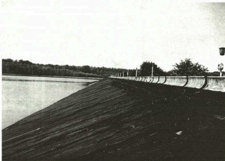
Bild 2: Schadhafte Außendichtung mit Wellenbrecher
