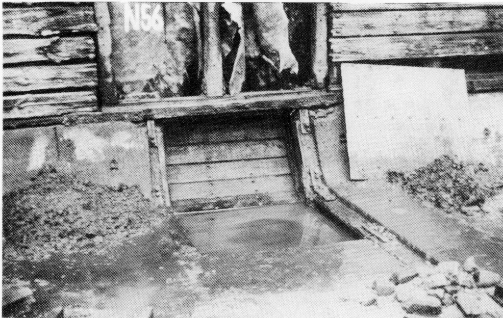
Bild 39: Trogsohle im Bereich einer Gelenkfuge (Wandanschluß)
