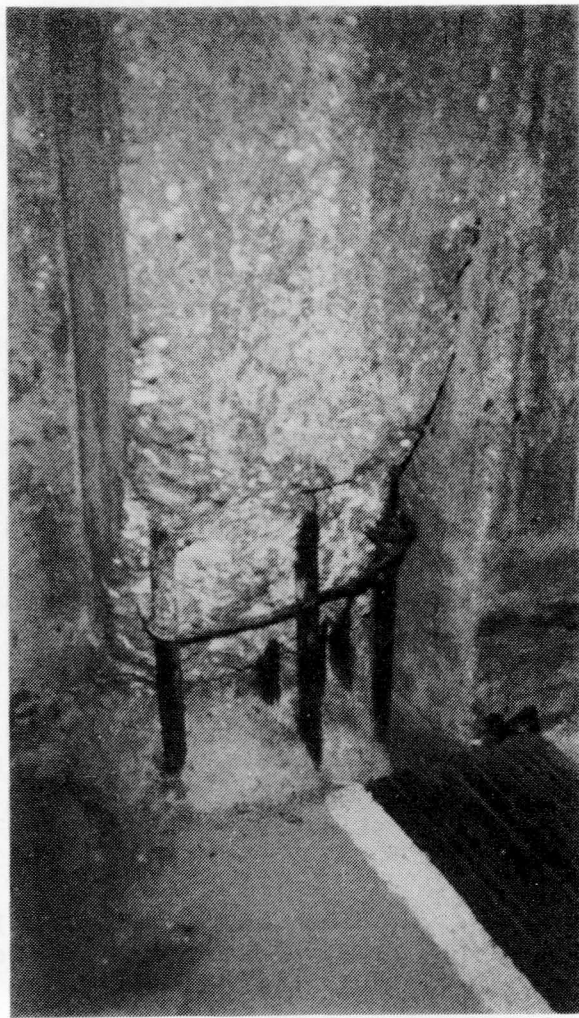
Bild 23: Querschnittsschwächung am Stielfußpunkt eines Stahlbetonrahmens im Strombrückenbereich
