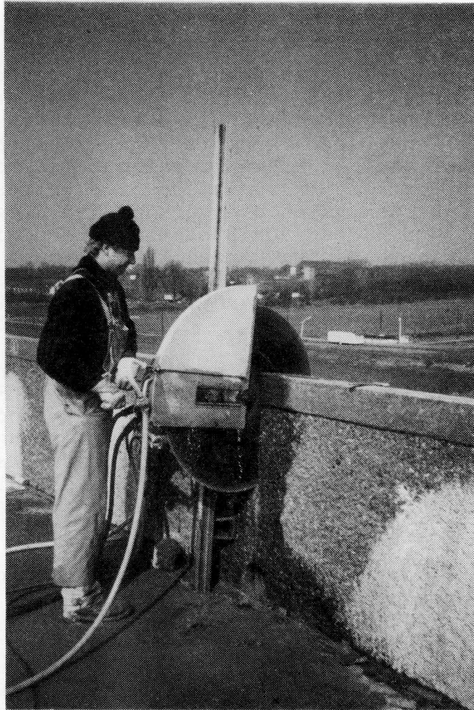
Bild 26: Abbruch der Stahlbetonbrüstungen im Strombrückenbereich durch vertikale und horizontale Sägeschnitte mit einer hydraulischen Wandsäge
