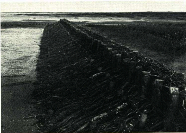
Abb. 5 Buschlahnung mit seeseitiger Spreutlage
