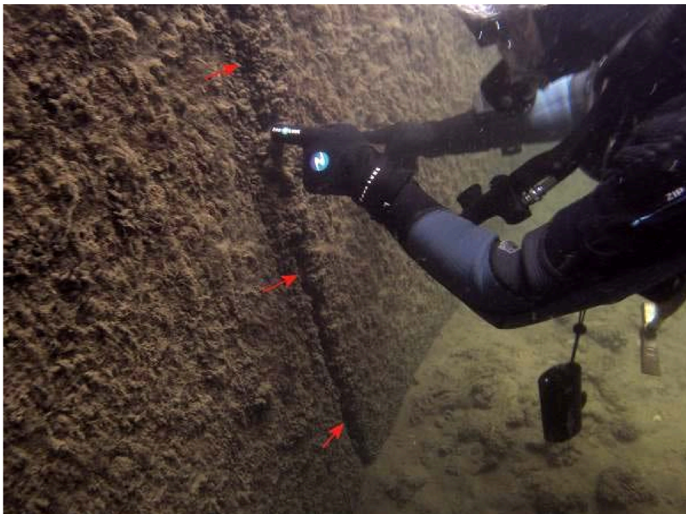
Abbildung 2: Technische Inspektion durch Wissenschaftliche Taucher. Die in situ Dokumentation ist besonders wichtig, da eine objektive Risikobewertung von der Wasseroberfläche nicht möglich ist Prüfung über Wasser mittels Brückenuntersichtgerät.
