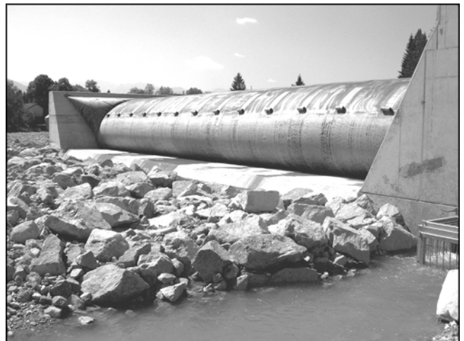
Bild 1: Schlauchwehr der Wasserkraftanlage Lechbruck/Lech (wassergefüllt)
