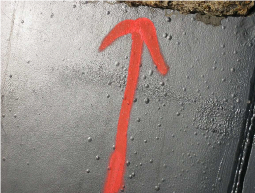
Bild 3: Ausbildung wassergefüllter Blasen auf einer lösemittelgeschädigten Epoxidharz-Stahlwasserbaubeschichtung durch Lösemittelretention
