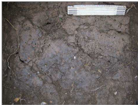
Abbildung 11: gealterte Dichtung mit Rissen und Wurzeleinlagerungen, Vergleichsschurf klassische Tondichtung
