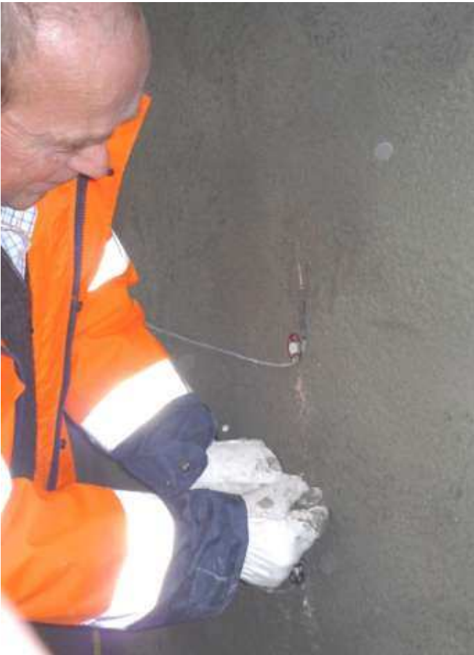
Bild B43: Befestigung der DMS in der ersten Spritzmörtelschicht (oberhalb eines Risses und außerhalb eines Risses (Referenz))
