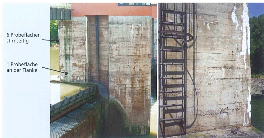
Bild 7: Wehrpfeiler 3 des Wehrs Horkheim. Links: Ansicht der Flanke. Rechts: Ausschnitt Stirnseite
