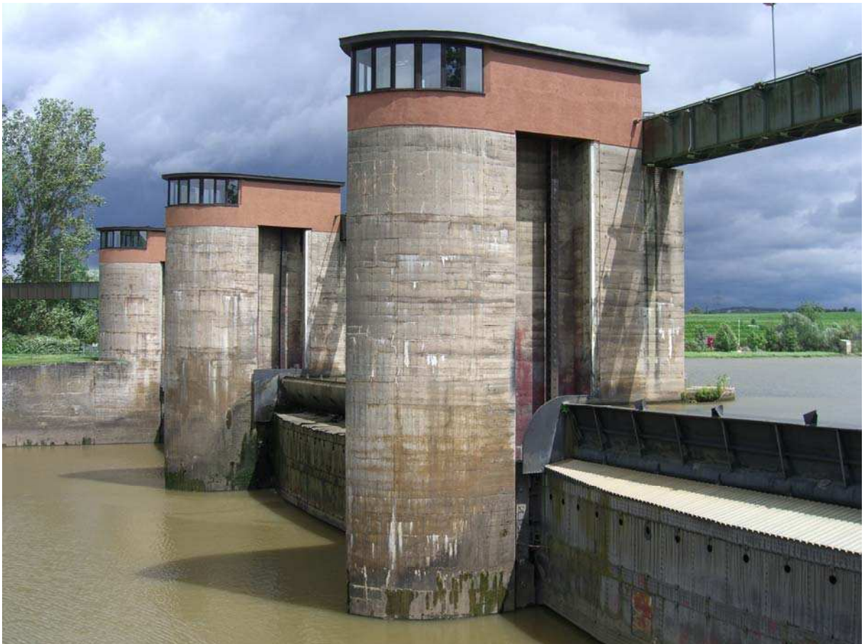
Bild 1: Wehrpfeiler mit Rissen und gerissenen Arbeitsfugen
