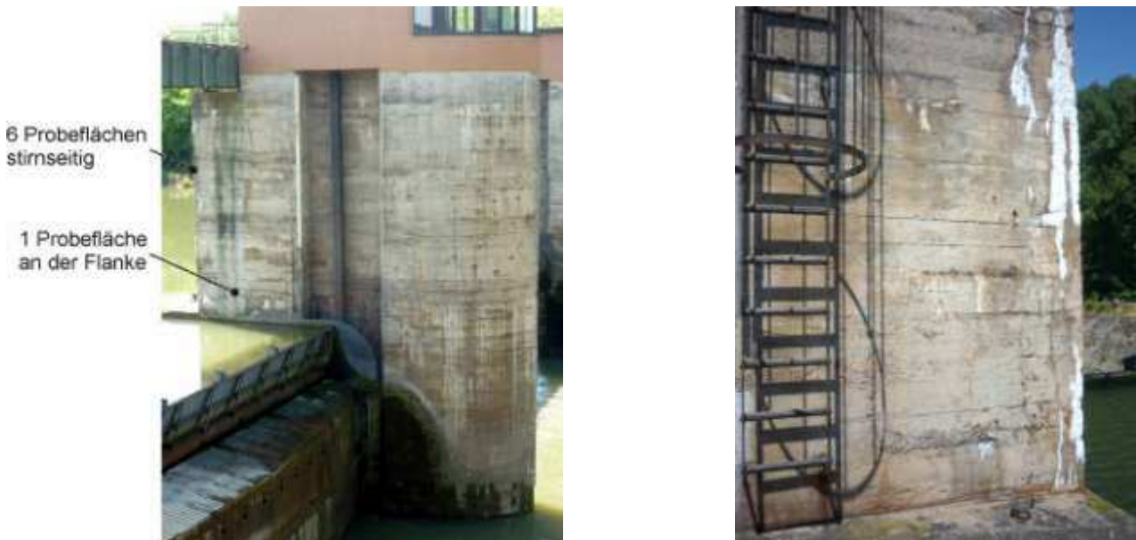
Bild 13: Wehrpfeiler 3 des Wehrs Horkheim. Links: Ansicht der Flanke. Rechts: Ausschnitt Stirnseite
