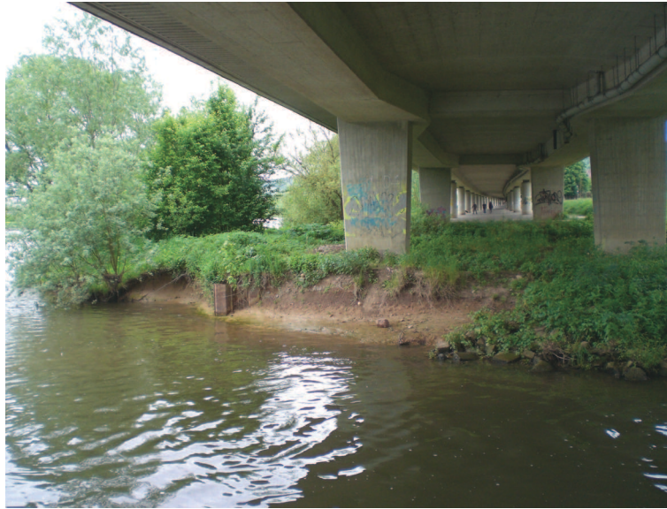
Bild 7: Erosionsschäden unter der B 37 Brücke 2010
