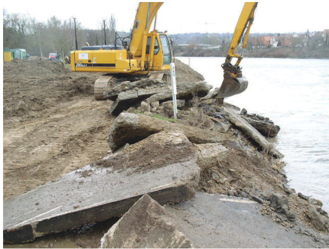
Bild 14: Der landseitige Ausbruch der betonierten Uferböschung 2009
