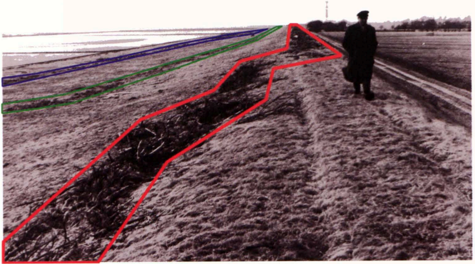
Abb. 2: Teek am Deich als Maß für den Wellenauflauf; hier für eine erste höhere und zwei weitere niedrigere am Seedeich bei Eckwarderhörne, Butjadingen
