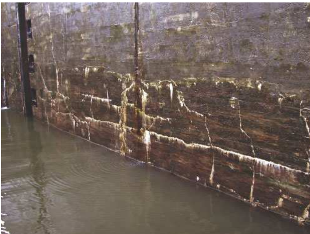
Bild 1.10: Schleuse Schwabenheim, Rissbildungen im unteren Kammerwandbereich
