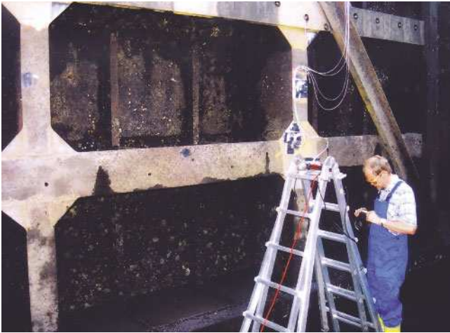
Bild 1.5: DMS-Installation am Untertor der Schleuse Petershagen
