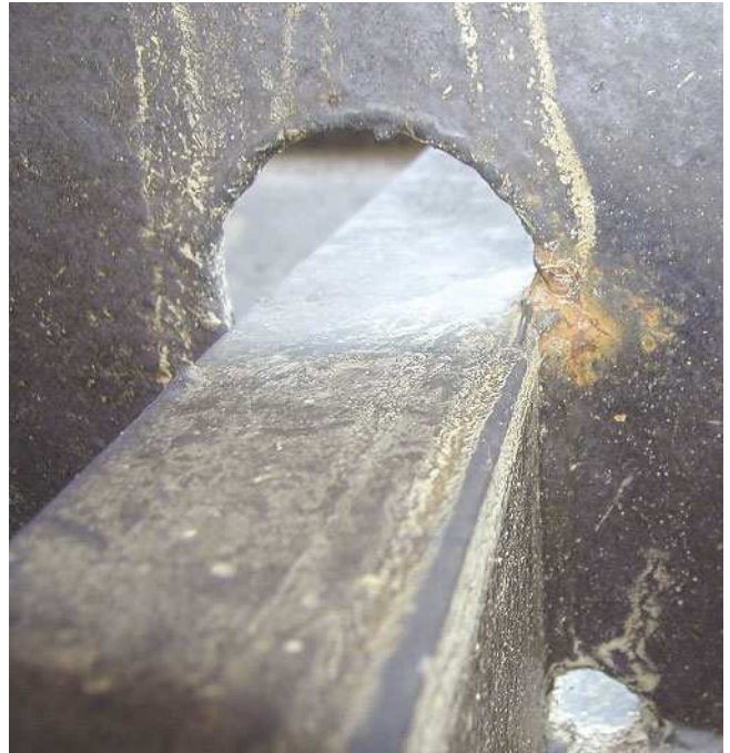
Bild 1.18: Schiffshebewerk Lüneburg – Detail Rissbildung
