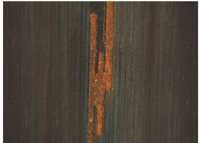
Bild 1.9: Stauwand nach extremer mechanischer Belastung der Beschichtung
