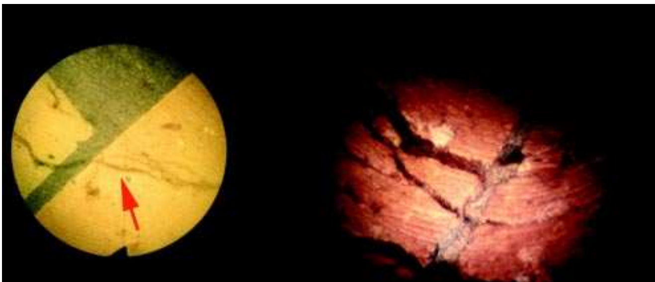
Bild 8: Endoskopieaufnahmen von Trennrissen im Ziegelmauerwerk einer Schleusenammerwand
