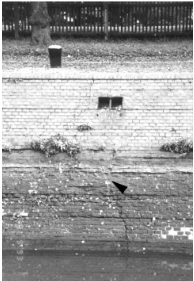
Bild 5: Senkrechter Trennriss an einer geneigten Kammerwand aus verkleinertem Stampfbeton
