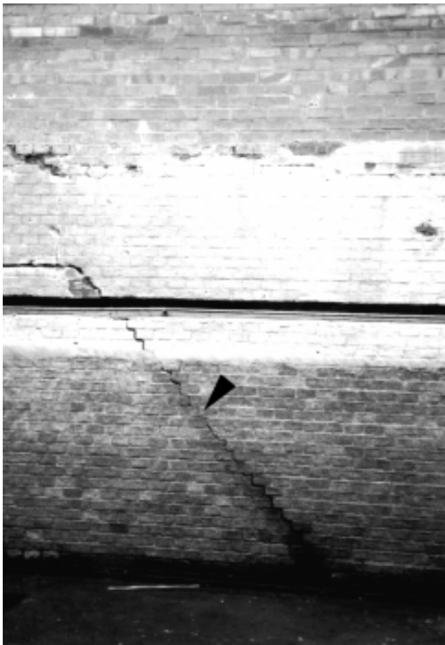
Bild 6: Abgetrepter, oben in die Horizontale übergehender Trennriss im Ziegelmauerwerk einer auf Holzpfählen gegründeten Kammerwand
