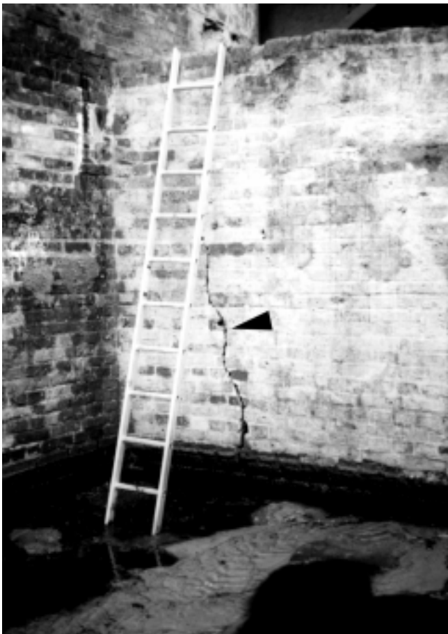
Bild 10: Trennriss mit Wasseraustritt und Sandausspülung am Drempel eines Schleusenhauptes aus Ziegelmauerwerk
