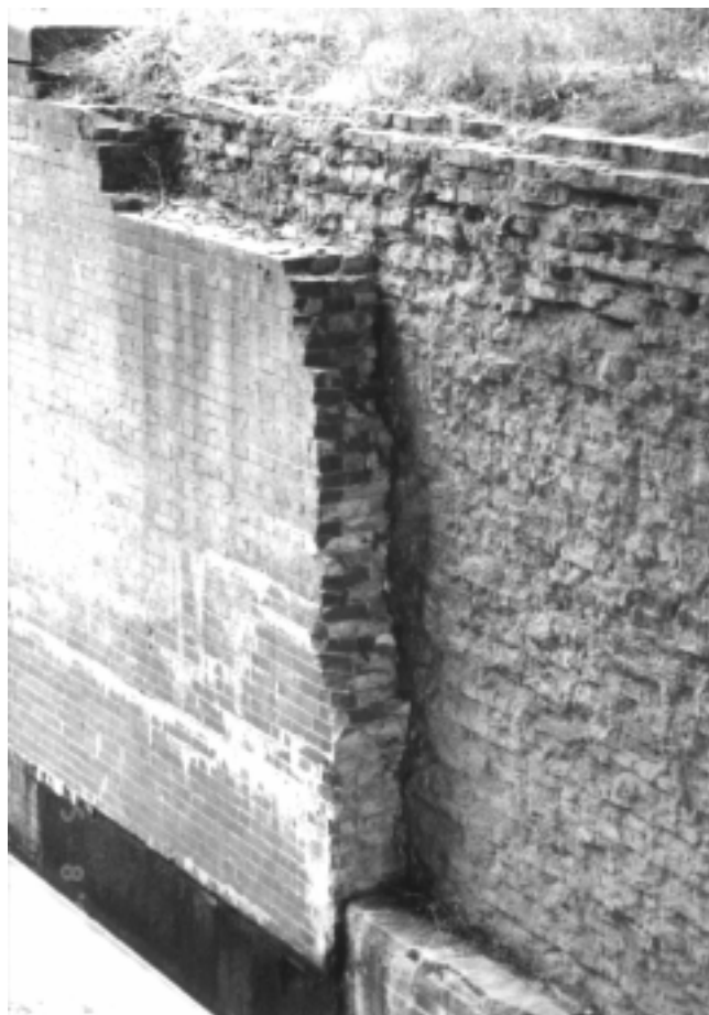
Bild 7: Schalenbildung mit Abbruch an einer verkleinerten Schleusenammerwand aus Ziegelmauerwerk
