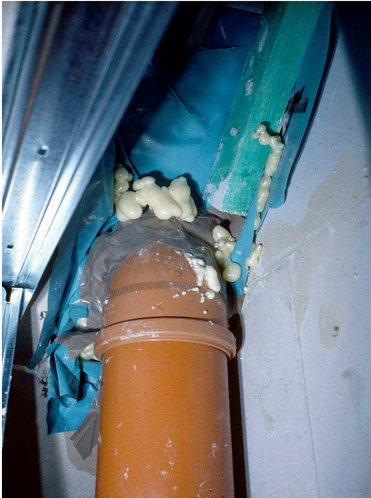
Bild 7: Mängel im Anschluss luftdichte Schicht an Lüftungsrohr.
