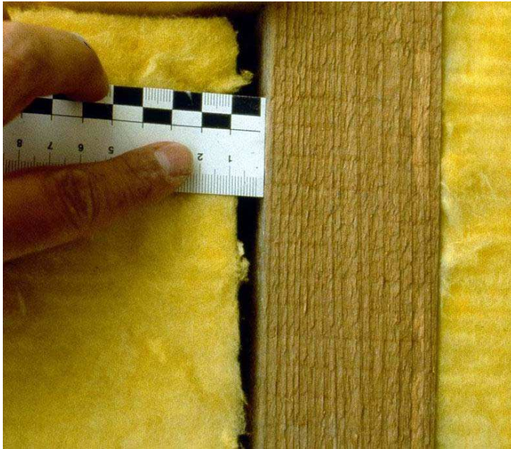
Bild 1: Fugen im Dämmstoff
