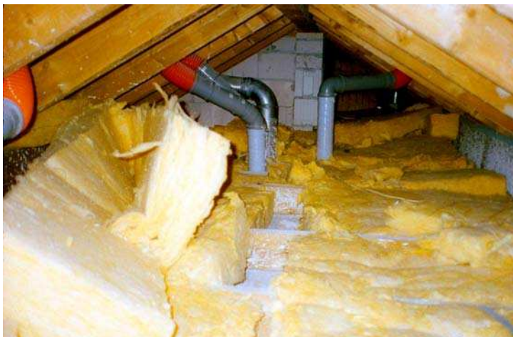
Bild 2: Fugen und Hohlräume im Dämmstoff
