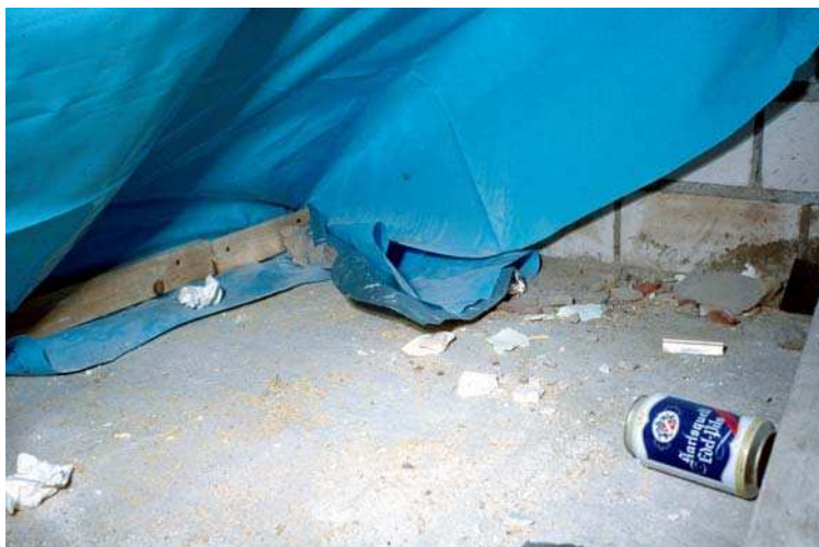
Bild 6: Fehlender Anschluss der luftdichten Schicht an das Mauerwerk.
