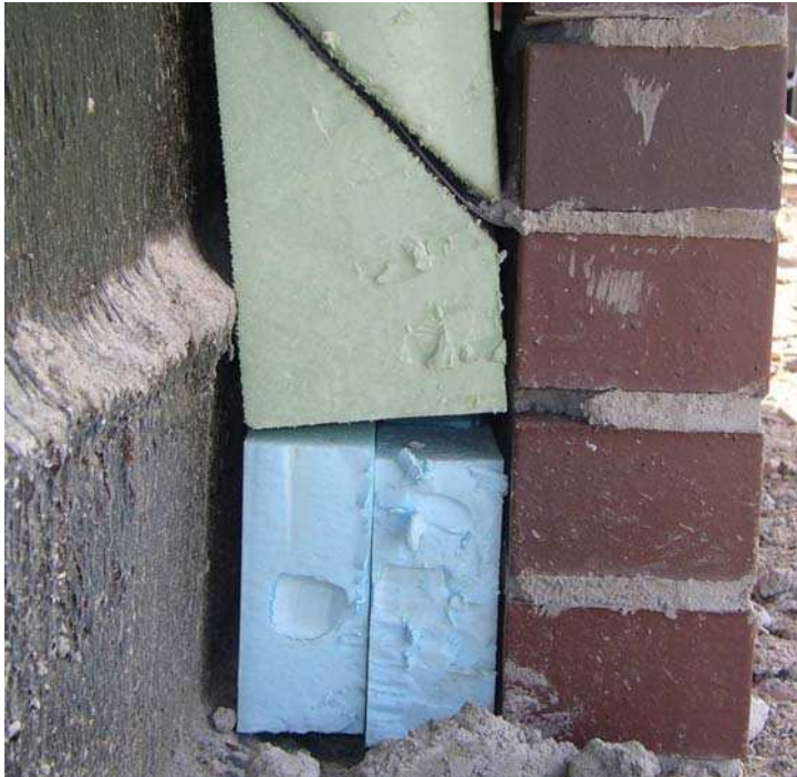
Bild 3: Hohlräume im Dämmstoff
