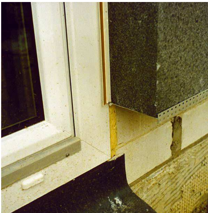
Bild 4: massive Wärmebrückenwirkungen durch Sockelabschlussprofil
