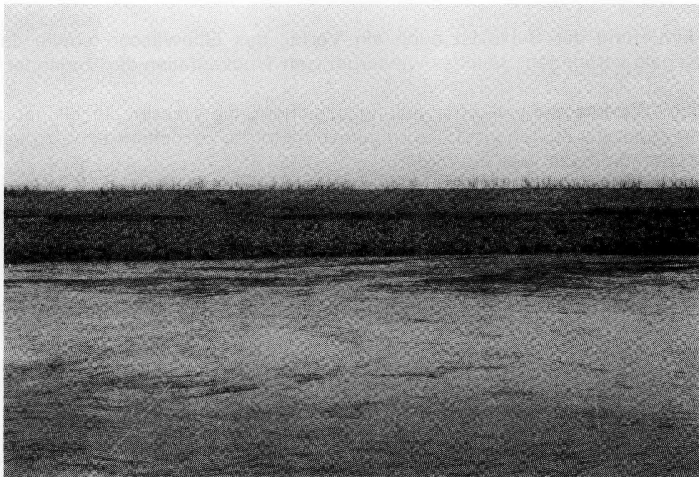
Bild 3 Abgerutschtes Deckwerk (Fehlende Böschungsfußsicherung)
