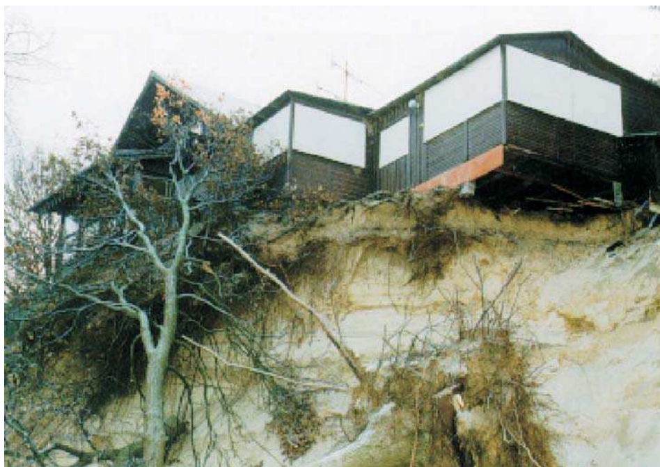
Abb. 3.5: Vom Abstürzen bedrohtes Gebäude an einem abgebrochenen Kliff. Foto: MBLU'96 (1996)
