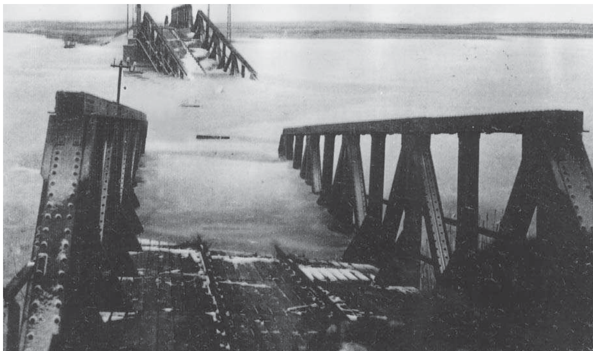
Abb. 3.1: Durch die Sturmflut am 30./31.12.1913 zerstörte Eisenbahnbrücke (Klör-Brücke) zwischen Bresewitz und Pruchten in Vorpommern (Darß-Zingster Boddengewässer). Foto: Archiv HUPFER
