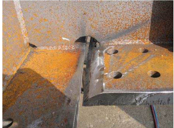
Ausgeschliffene mangelhafte Schweißnaht
