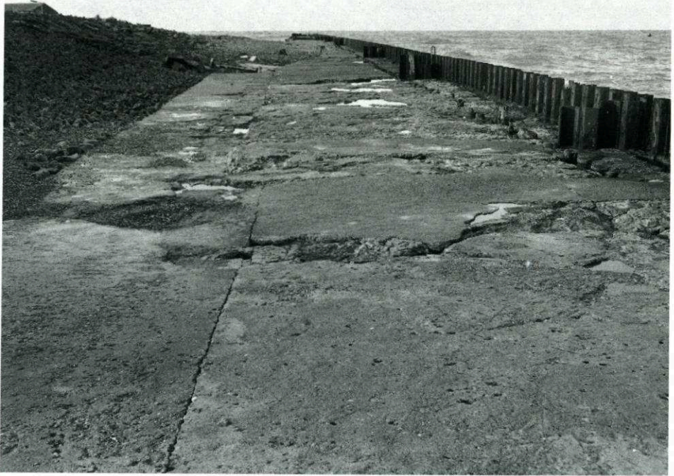
Abb. 3: Schadhafes Nordost-Bohlwerk Mitte der 70er Jahre (Insel-Foto Cohrs)
