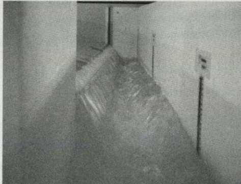
Abbildung 2 HWE – Sammelrinne bei BHQ1 (leeres Becken)
