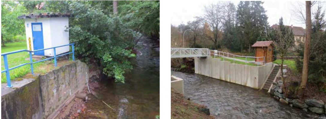
Abbildung 2: Pegel Georgenthal 1 / Apfelstädt: Schäden nach dem Hochwasser 2013 (links) und neu errichtete Pegelmessstelle (rechts)
