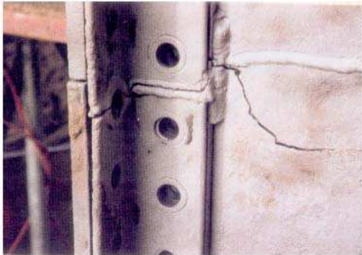
Bild 4. Erneut gerissene Schweißnaht (Rissreparatur)
