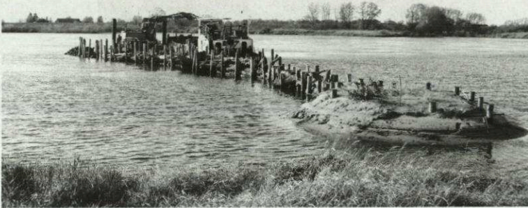
Abbildung 2: Totholzbuhrne in der Bauphase mit hinterströmte keulenartiger Verdickung am Ende des Buhrnenkörpers
