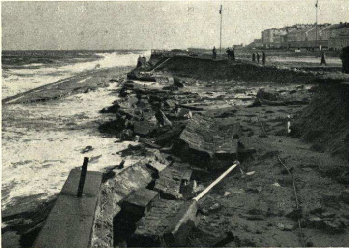
Abb. 34. Zerstörungen am Deckwerk oberhalb der Wandelbahn auf Norderney
