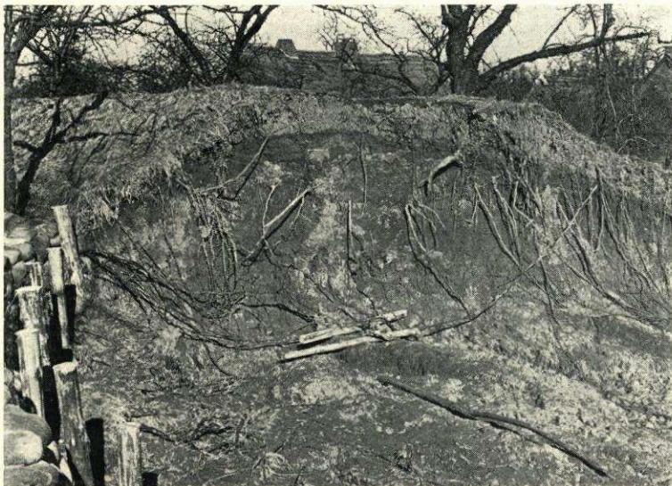
Abb. 15. Bruch eines Deiches im Alten Land. Der mit Bäumen bestandene Deich ist stark durchwurzelt
