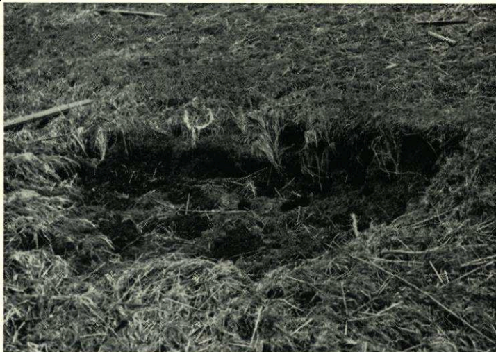
Abb. 6. Leichter Schaden in der Außenböschung Aufn. Wasserwirtschaftsamt Aurich, Außenstelle Leer
