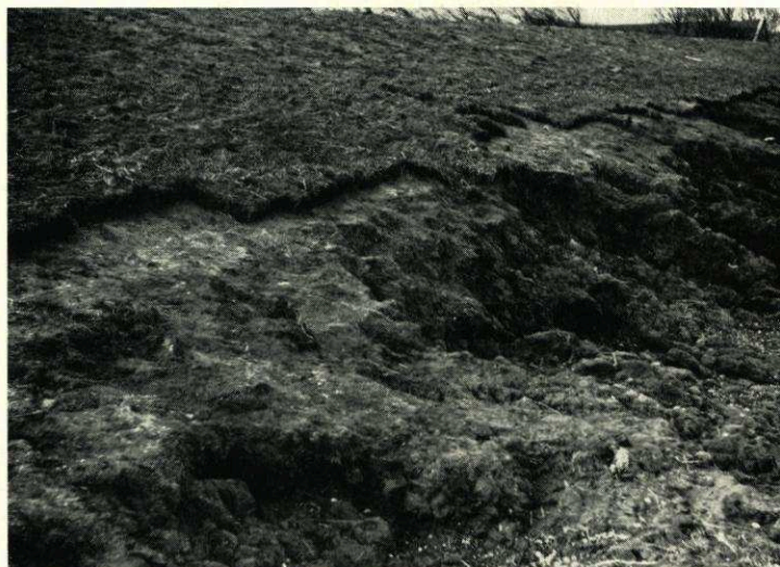
Abb. 7. Mittlerer Schaden in der Außenböschung Aufn. Wasserwirtschaftsamt Aurich
