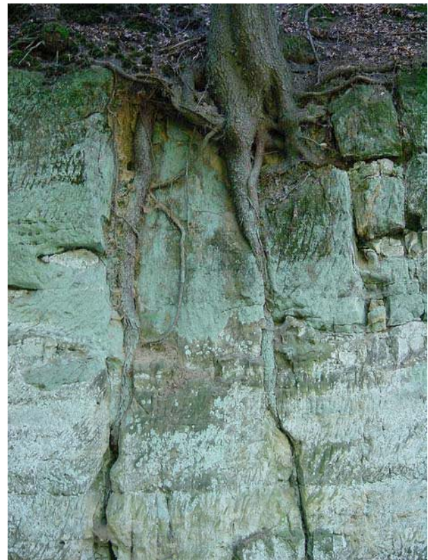
Bild 4: Verwitterungszone im Sandstein mit Pflanzenwurzeln in Vertikalklüften. Die Wurzeln zersetzen einerseits das Gestein und andererseits weiten sie die Trennfugen auf.
