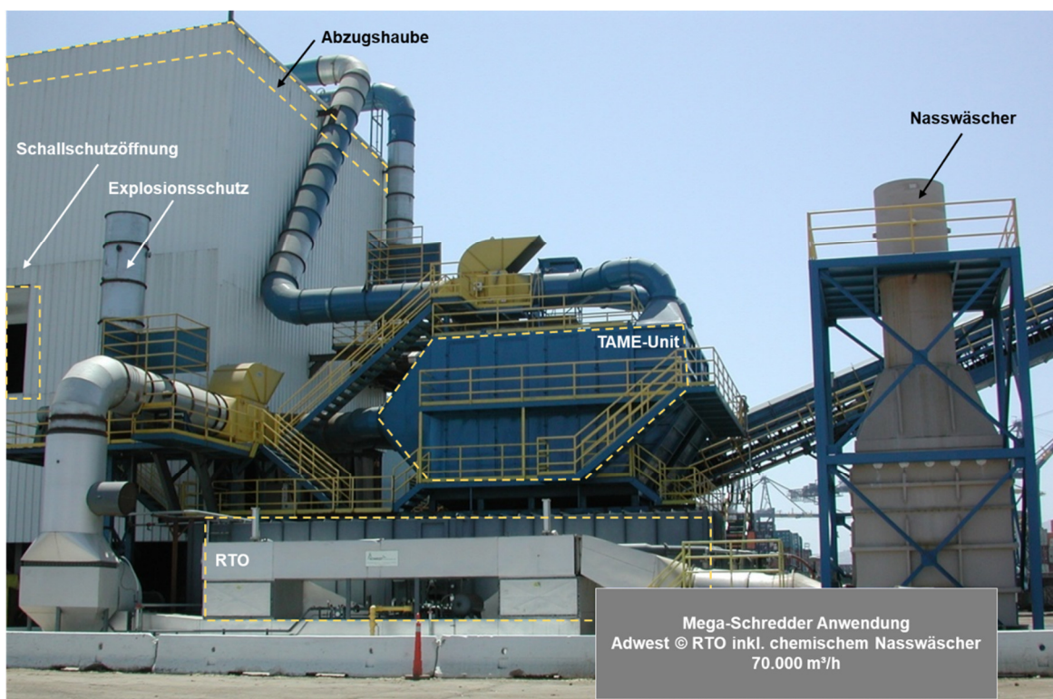
Abbildung 49: VOC-Reduktionseinrichtung SA Recycling LLC USA 2018
