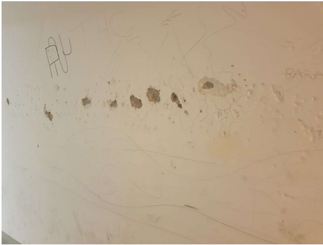
Abbildung 8: Vandalismus im Stiegenhaus
