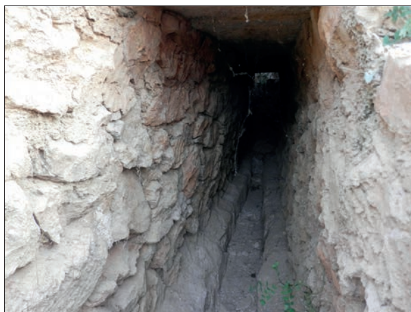
FIG. 7. Galería de conducción del Caño de Inchola.
