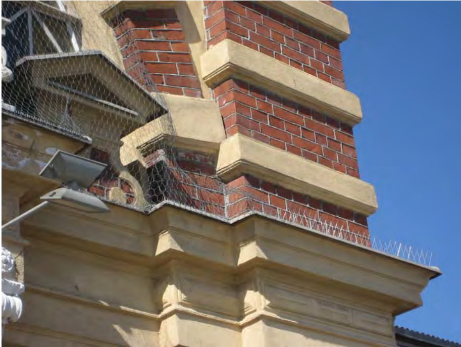
Kuva 6. Kauppahallin itäisen ulko-oven yläpuoliset laskeutumisesteet. Kuva: Pekka Paaer.
