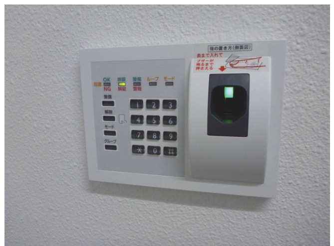
図 1 3 ロッカー室入口にあるカードリーダー
