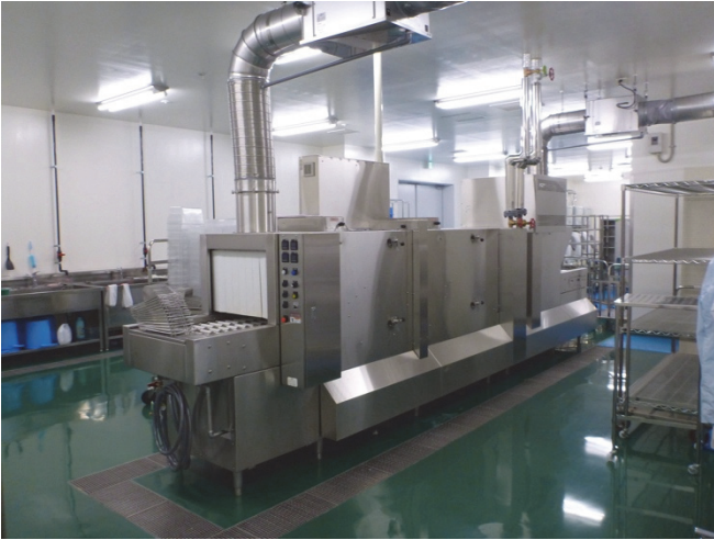
図5 洗浄室ケージ洗浄機
