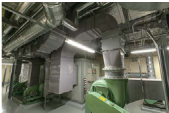
図—4 光触媒脱臭装置
