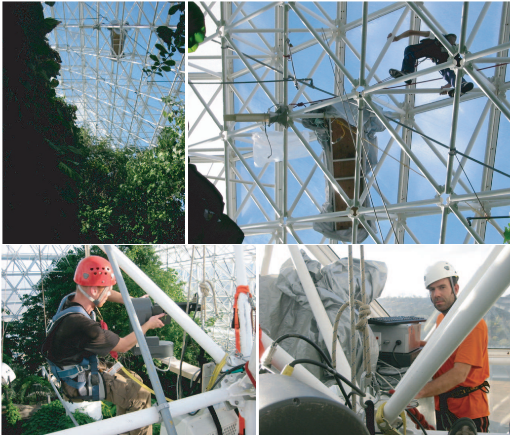
Abbildung 6.4: Kronendachrekonstruktion: ( oben ) Lage der Messplattform im Innengerüst des Regenwaldbioms. Sie ist in etwa 15 Meter Höhe installiert. Der Zugang zur Messplattform erfolgt durch das Gerüst, die Kletterer sind durch ein Fixseil gesichert. ( unten ) Montierter Kameraarm und Messplattform: Die Drehungen erfolgten von Hand, da die Fernsteuerung nicht funktionierte.
