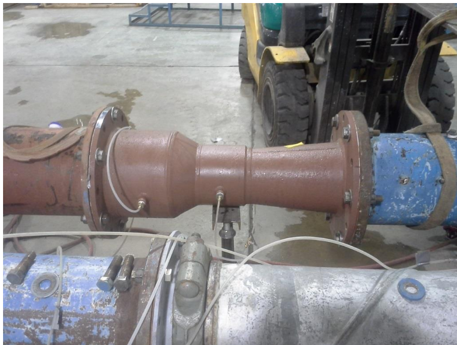
Fig. 12. Halmi Venturi meter installation.
